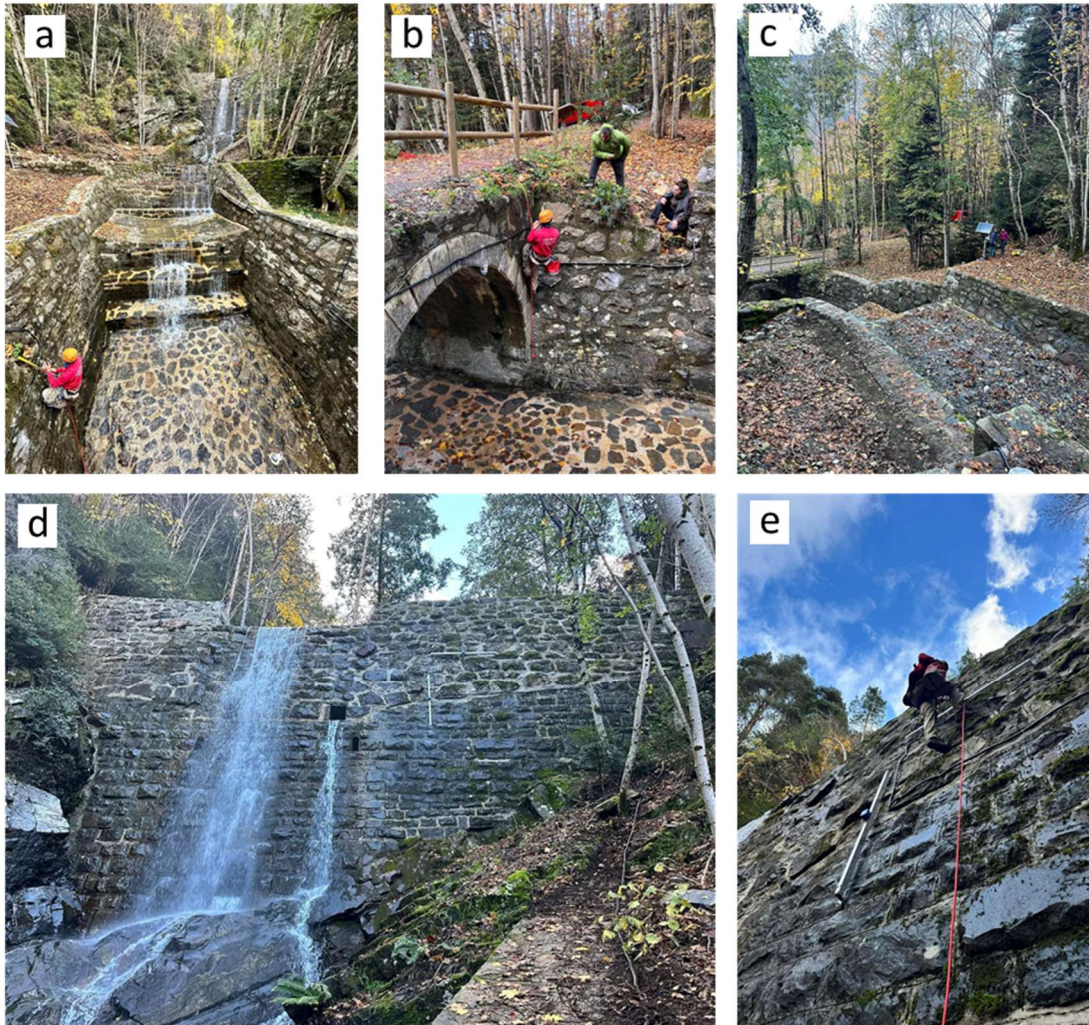
Figura 2. Detalles del sistema de monitoreo instalado en el dique 1 de Epifanio. a,b) detalles de la instalación del sensor radar debajo del puente de la pista forestal, c) vista del panel solar que alimenta al datalogger para enviar los datos de forma remota. d) vista del dique donde las dos barras instaladas con sensores de alta precisión han sido instaladas (e).
