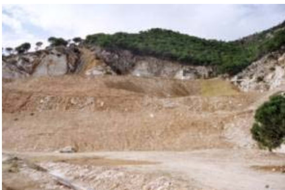
“Vista parcial de la cantera: iniciados los trabajos de instalación de manta orgánica, tras el perfilado del talud”
