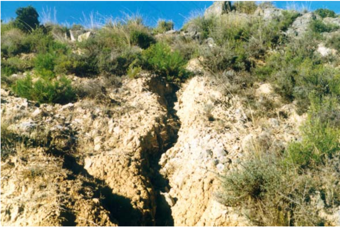
Foto 1. Estado preoperacional. Surcos producidos por el subsolado siguiendo líneas de máxima pendiente. Año 1998.
